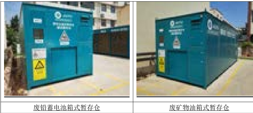
图4-8 国网安阳供电公司危废仓照片
